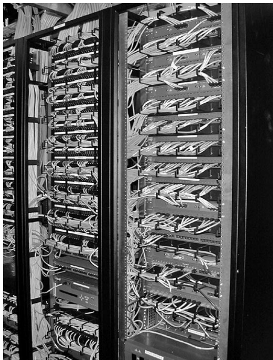
Рис. 6.11. Сетевые стойки в корпорации GNAC (патч-панели подключены к подвесным кабелям, а те – к заранее подготовленным кабелям патч-панелей на верхней части каждой стойки с узлами сети)
