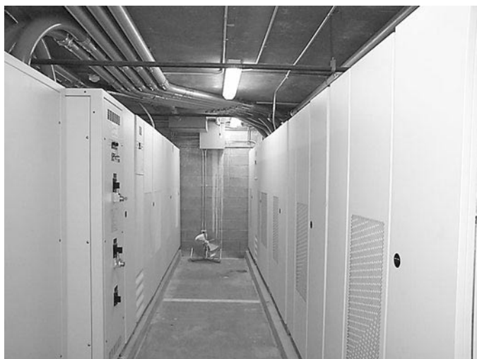
Рис. 6.1. Модульный ИБП в корпорации GNAC
